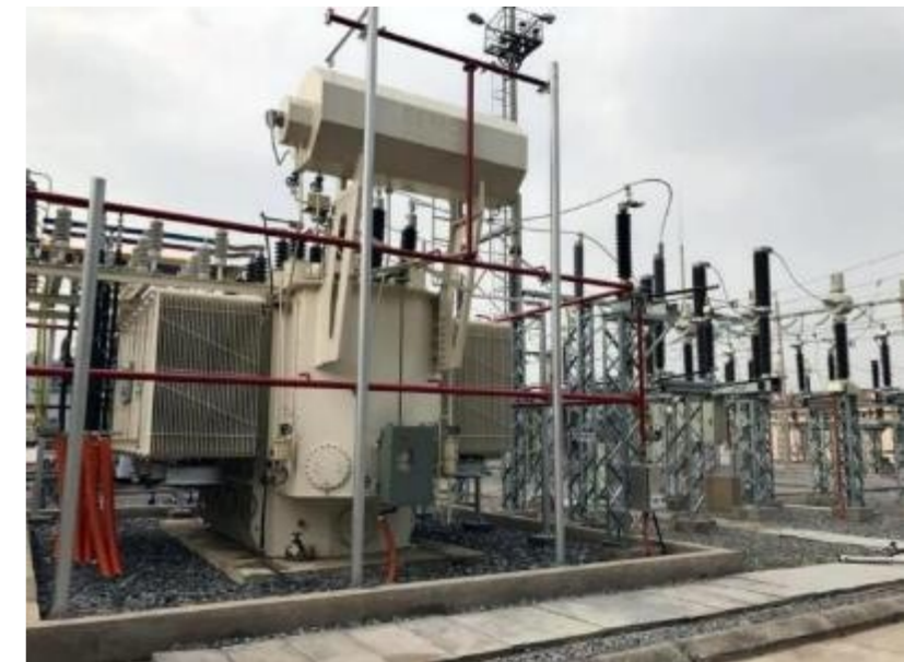
Trạm 110kV có công nghệ chữa cháy tự động tại Hải Dương
